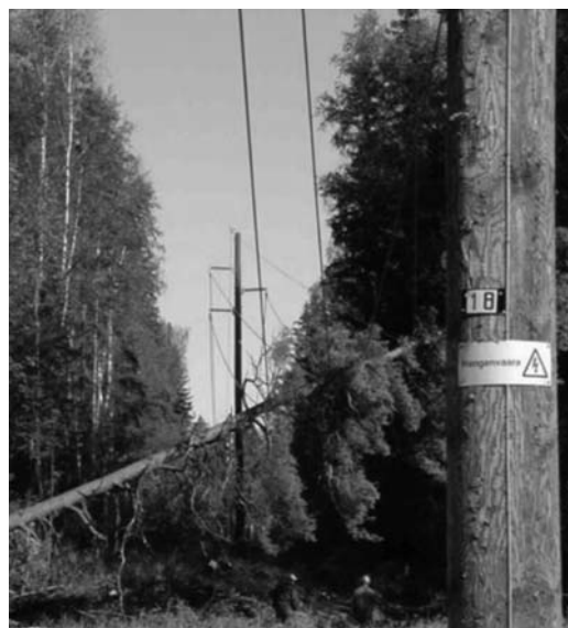
Рис. 15. Дерево, упавшее на линию ВЛЭЗ (воздушная линия электропередач среднего напряжения с проводами с защитным покрытием)
